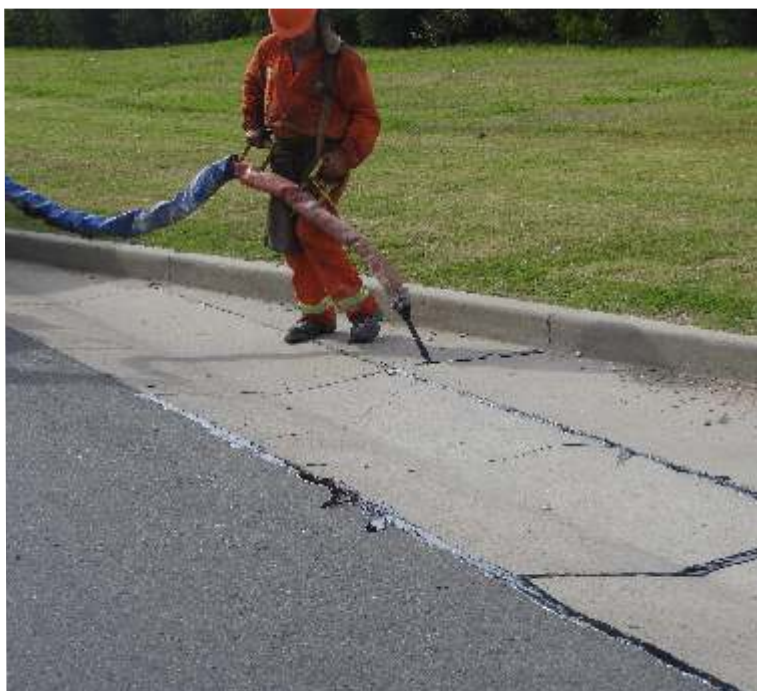
Junta sellada sobre pavimento rígido.
