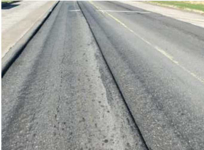
▲ Deformación transversal, pérdida de perfil.
