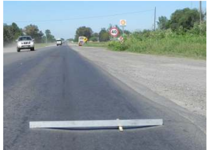
▲ Ahuellamiento excesivo, mayor a 10 mm.
